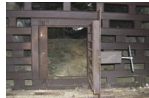
Porte de haute sécurité à Gauberg, Allemagne.
