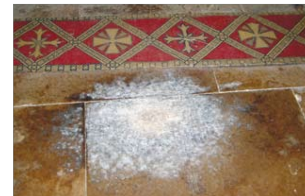
Illustration 13. Dégâts sur la pierre au prieuré de Penmon, Pays de Galles, Royaume-Uni, par suite d'une exposition prolongée à l'urine de chauves-souris. © J. Matthews
